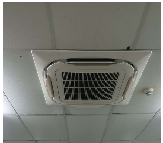
Hình ảnh dàn lạnh tại khu vực kiểm tra
