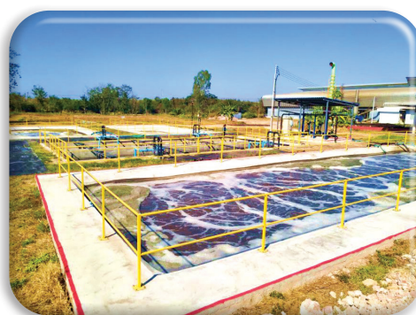
ระบบบำบัดน้ำเสียชีวภาพที่ 2
