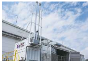
水素製造装置(白河工場)
