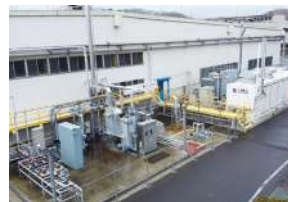
水素ボイラーと水素製造装置(白河工場)
