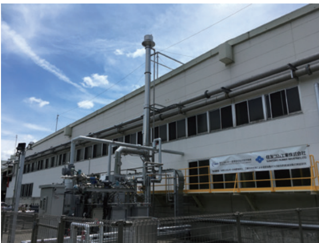
当社白河工場に設置している水素ボイラー
