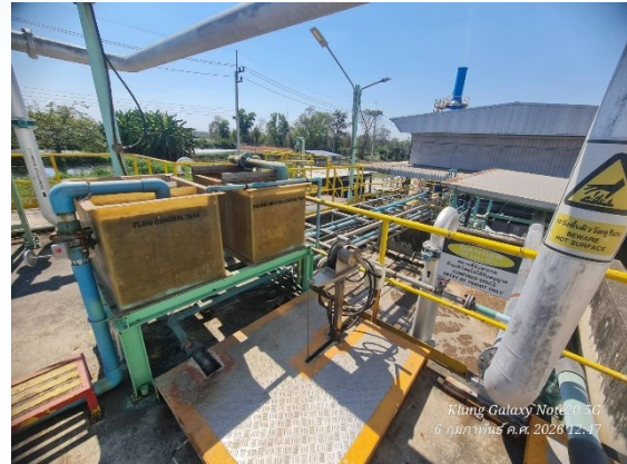
ระบบบำบัดน้ำเสียที่2 300 m 3 /day
